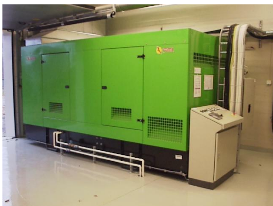
Figur 6 – Reservdiesel vid Fredriksbergs vattenverk
