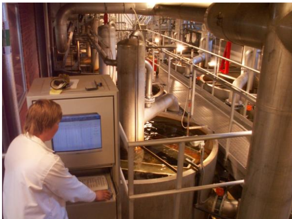
Figur 5 – Fredriksbergs vattenverk i Oskarshamn
